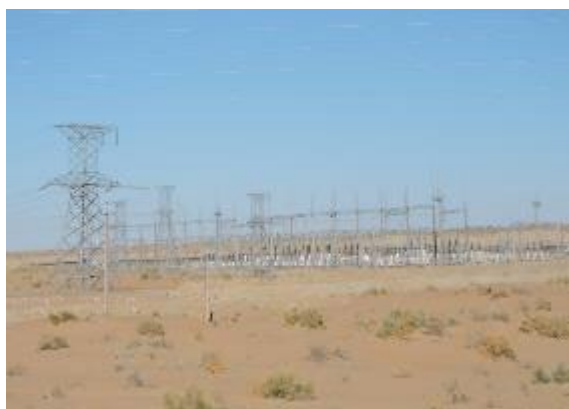
Рис. 8: Подстанция Сарымай (Источник: Juru Energy)
