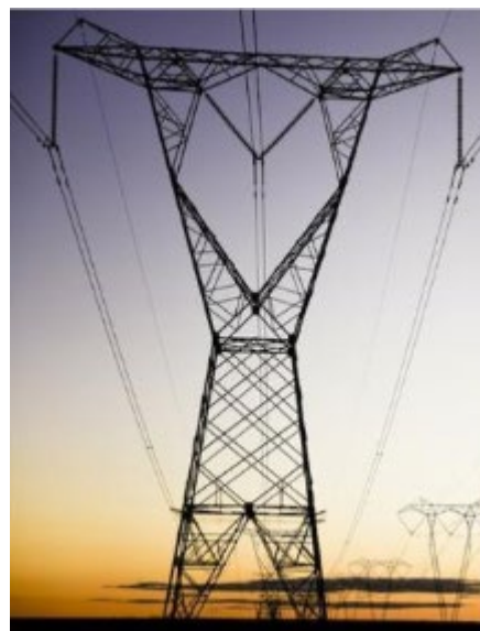
Рис. 27: Самонесущая стальная решетчатая подвесная башня 500 кВ (одноконтурная) (Источник: "НЭСУ")
